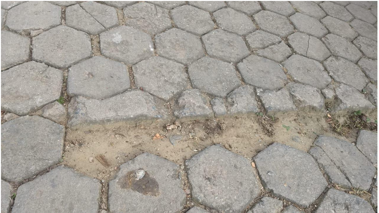
Figura 4 - Detalhe para blocos sextavados deteriorados.
