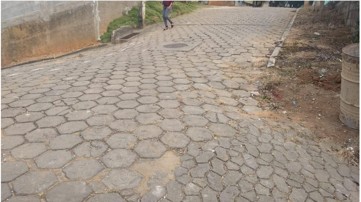
Figura 7 - Detalhe para blocos sextavados e meio fio deteriorados e desnivelamento do calçamento existente.
