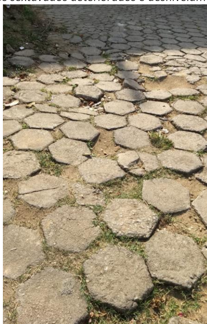
Figura 2 - Detalhe para blocos sextavados deteriorados.
