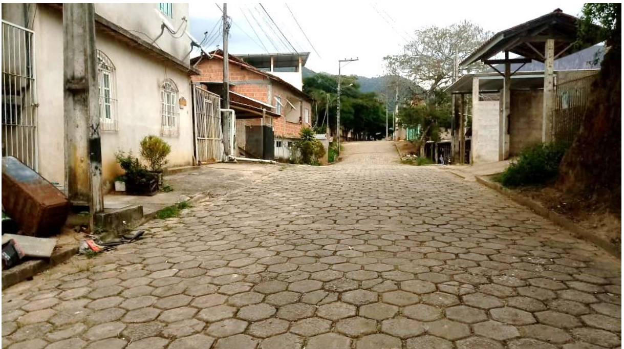
Figura 8 - Detalhe para ausência de calçamento acessível.
