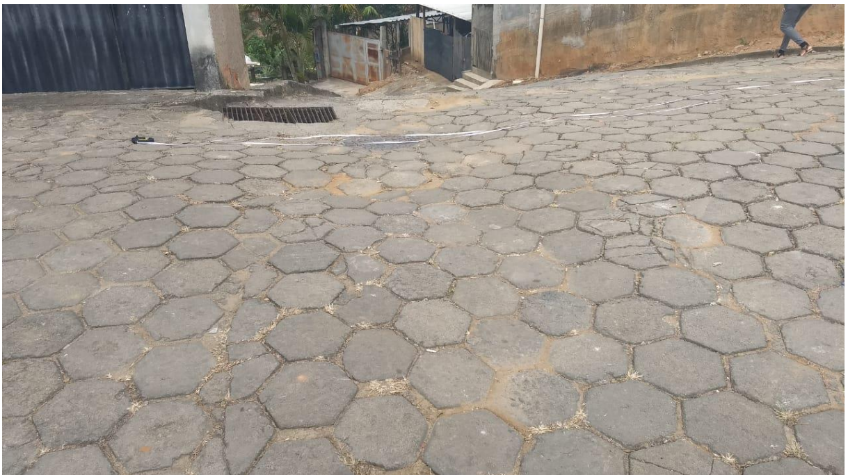
Figura 6- Detalhe para blocos sextavados deteriorados e desnivelamento do calçamento existente.
