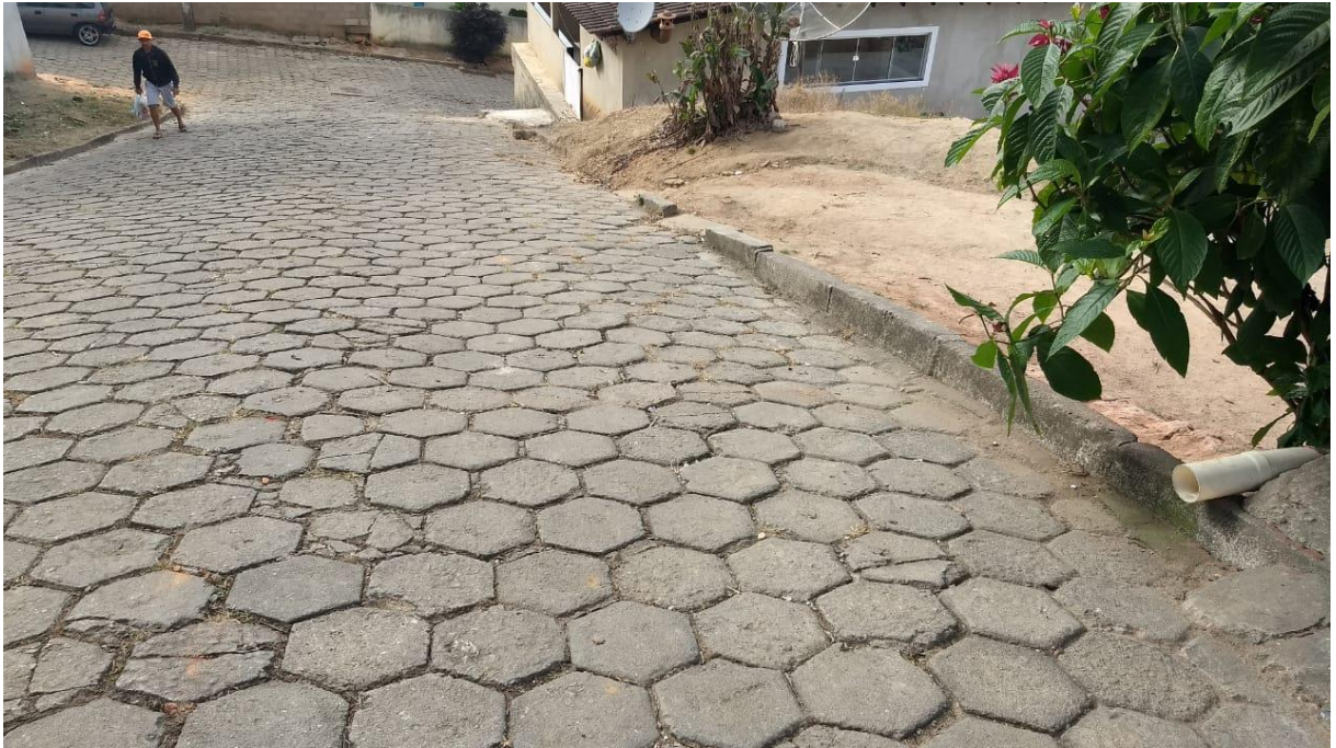
Figura 5 - Detalhe para blocos sextavados e meio fio deteriorados.
