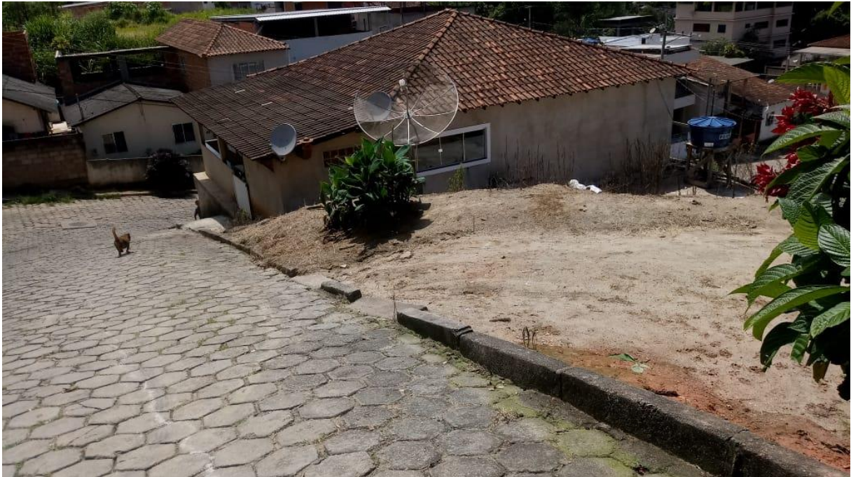
Figura 11- Detalhe para blocos sextavados e meio fio deteriorados, desnivelamento do calçamento existente ausência de calçamento acessível.
