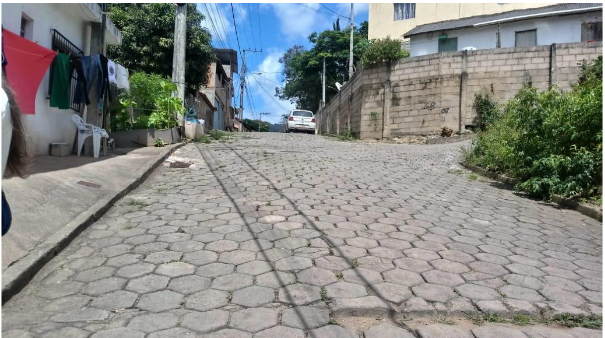
Figura 10 - Detalhe para blocos sextavados e viga de travamento deteriorados e desnivelamento do calçamento existente.
