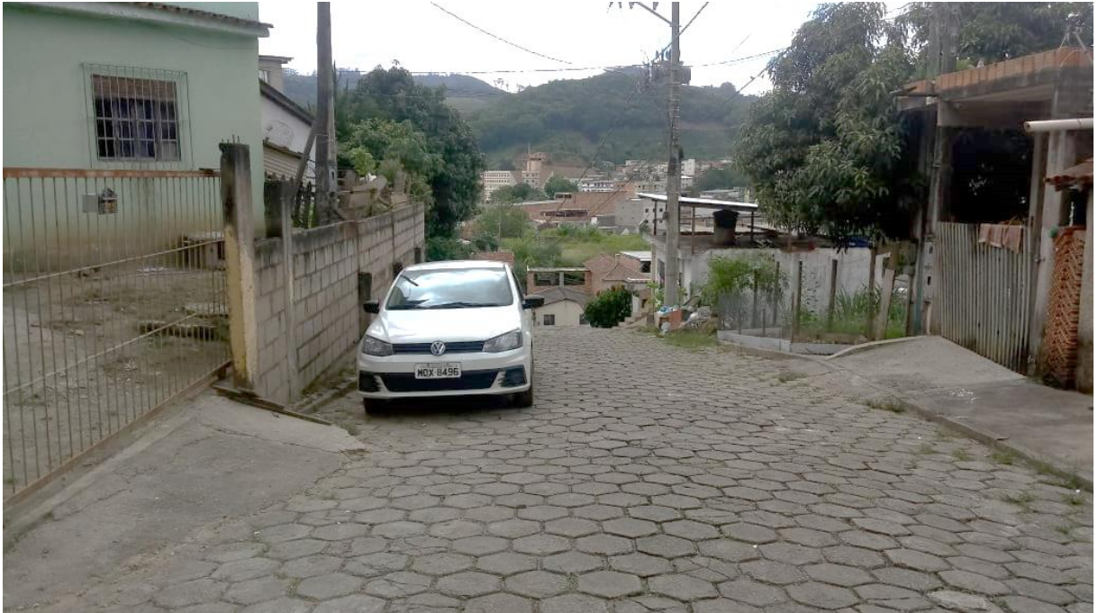
Figura 9 - Detalhe para blocos sextavados deteriorados e desnivelamento do calçamento existente.
