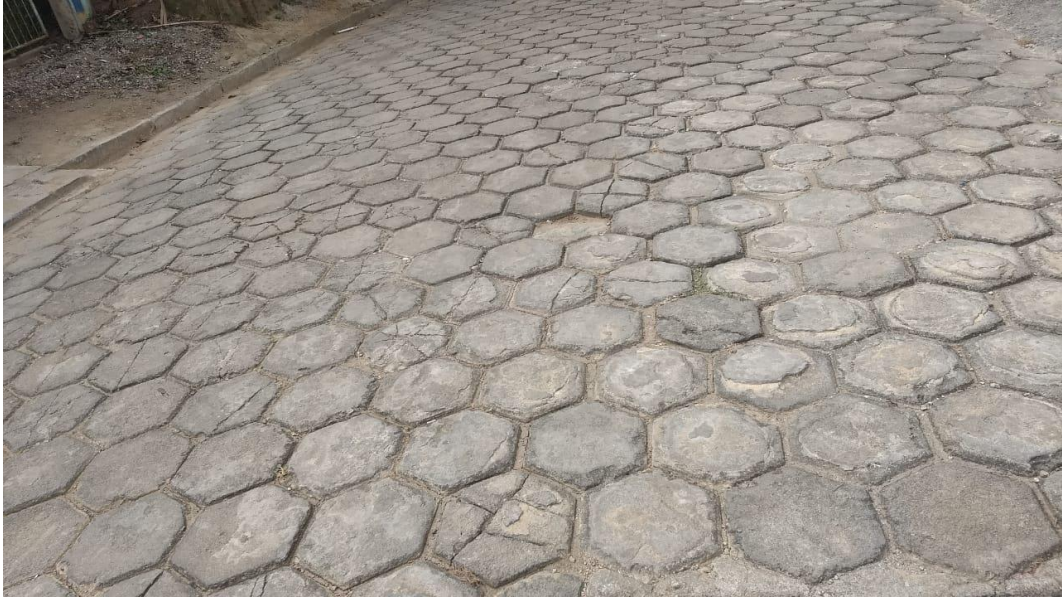
Figura 3 - Detalhe para blocos sextavados deteriorados e desnivelamento do calçamento existente.
