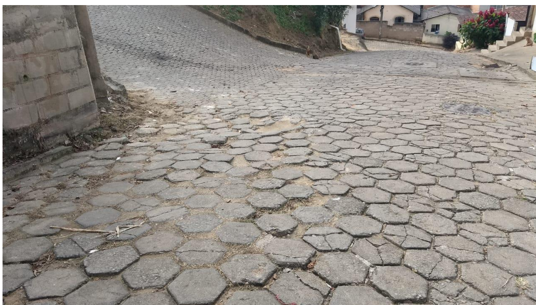
Figura 1 - Detalhe para blocos sextavados deteriorados e desnivelamento do calçamento existente.
